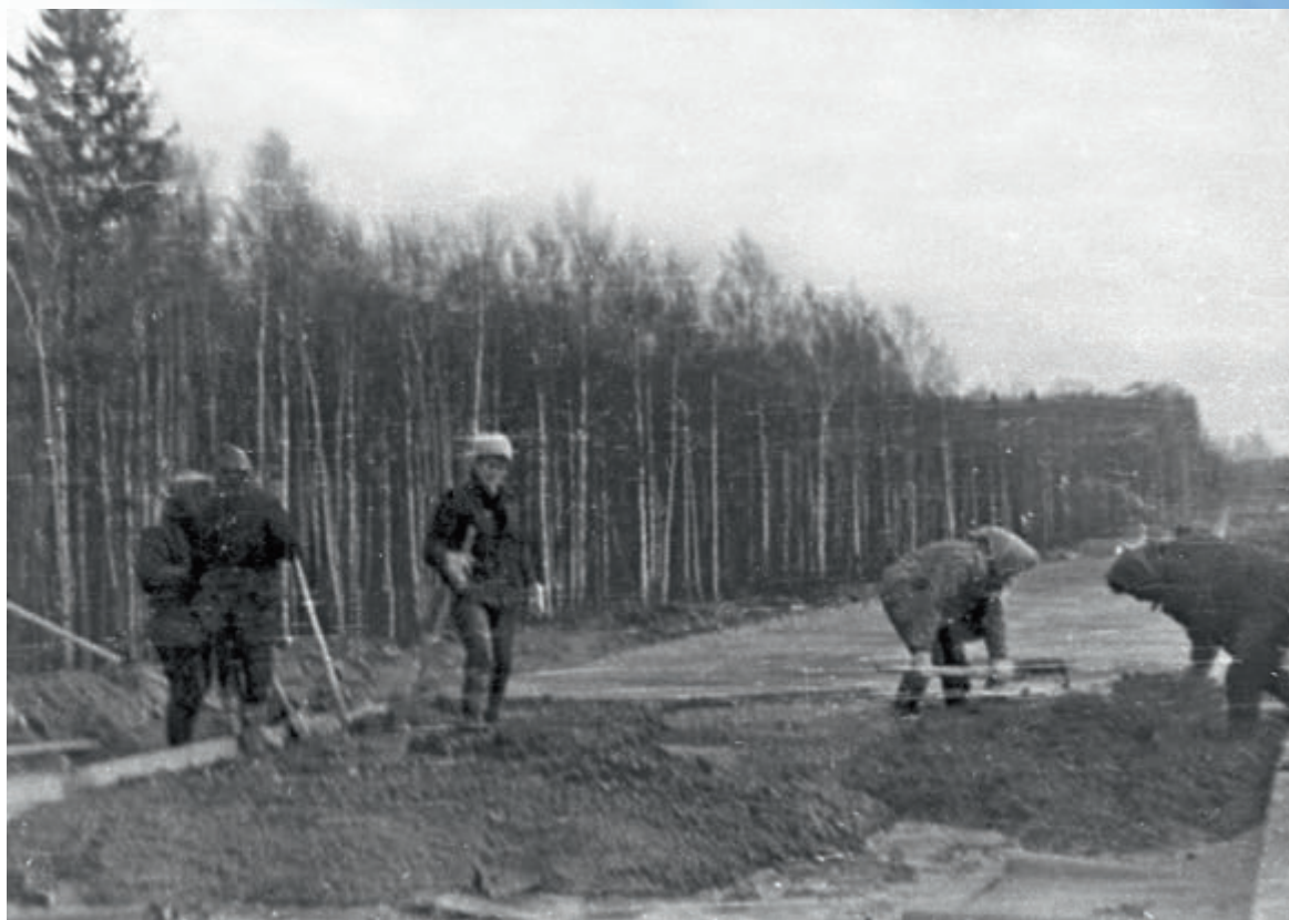
В 1960-е годы доля ручного труда при возведении объектов полигона была очень высока
